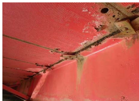
No181_胡摩手橋 (床板) 腐食
