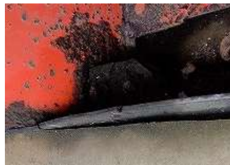
No41_堰土橋 (主桁) 腐食、防食機能の劣化
