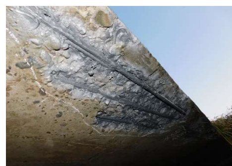
No286_田越2号橋 (主桁) 剥離・鉄筋露出
