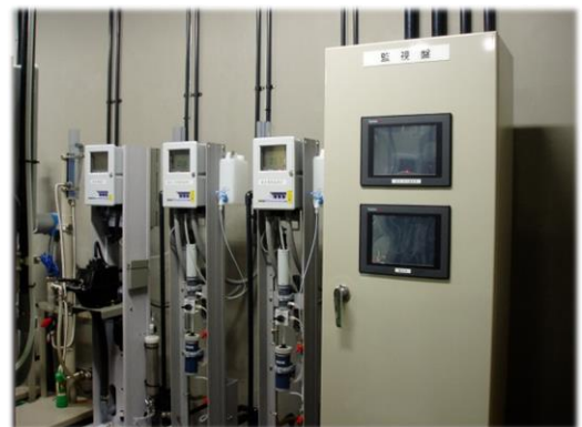
山武浄水場の水質監視設備
