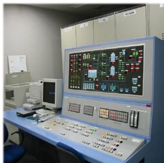
山武浄水場の遠方監視システム
