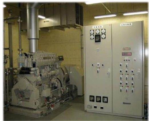
山武浄水場の自家発電設備
