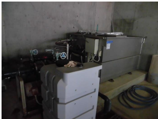
▼プール 機械室
