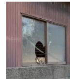
窓が割れた管理不全空家
