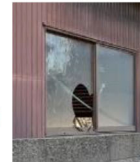
窓が割れた管理不全空家
