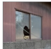
窓が割れた管理不全空家
