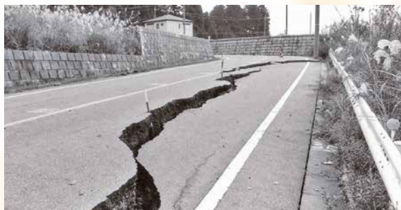
千葉県東方沖地震による地割れ（成東 愛宕台付近）
