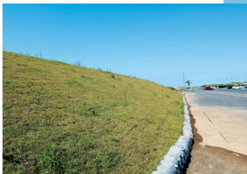
整備が待たれる本須賀海岸防潮堤
