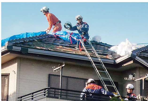
台風による住宅被害
