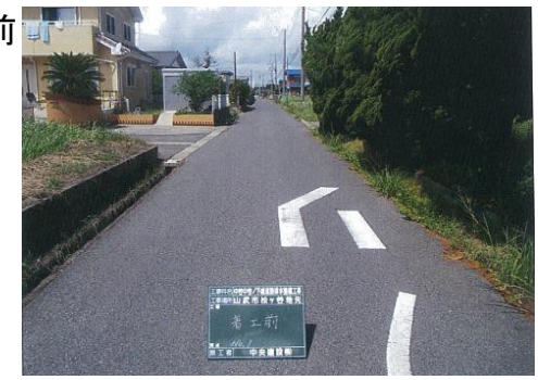
側溝に蓋がない状況
