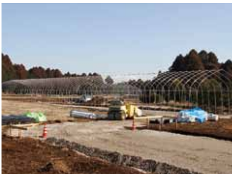
●移転予定地では、急ピッチで工事が進んでいた（山武市森）
