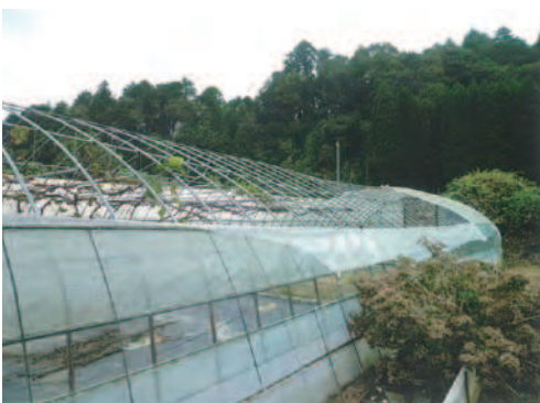
台風の強風によりビニールがはがれたハウス
