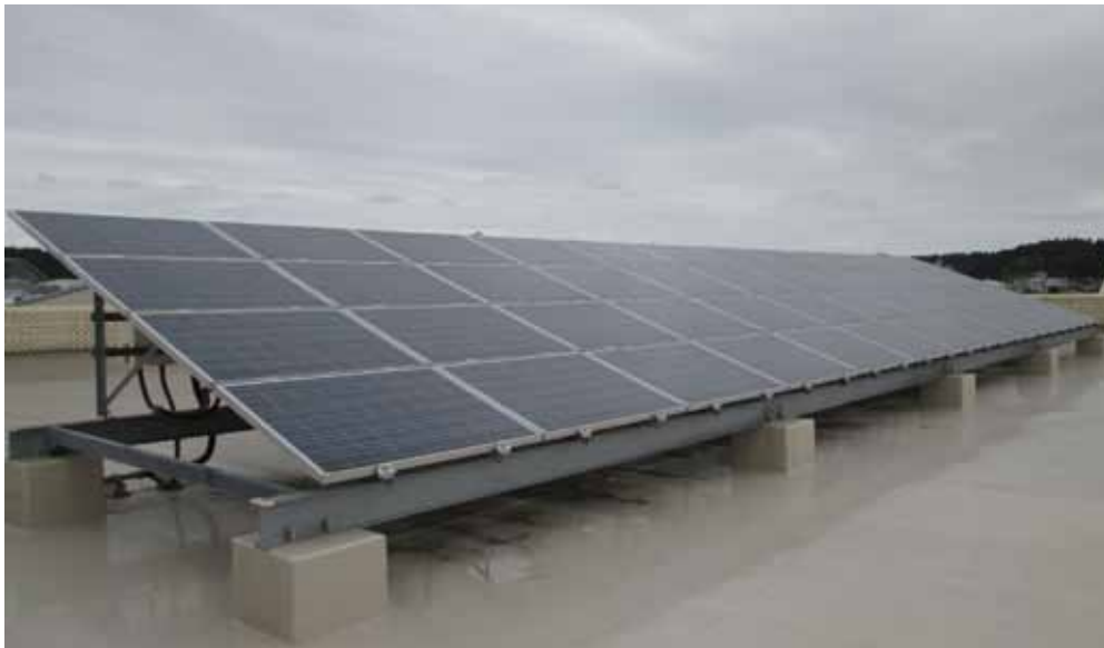
市役所屋上に設置されている太陽光パネル
