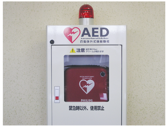
庁舎に設置されているAED
