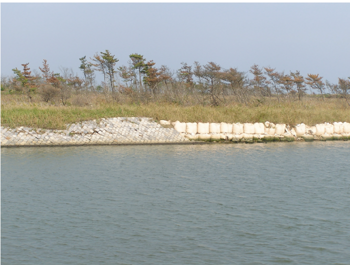
早急な改修が望まれる木戸川河口付近
