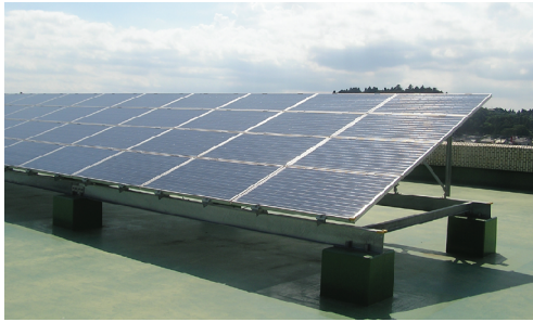
太陽光パネル
