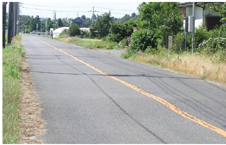
排水整備が必要な道路
